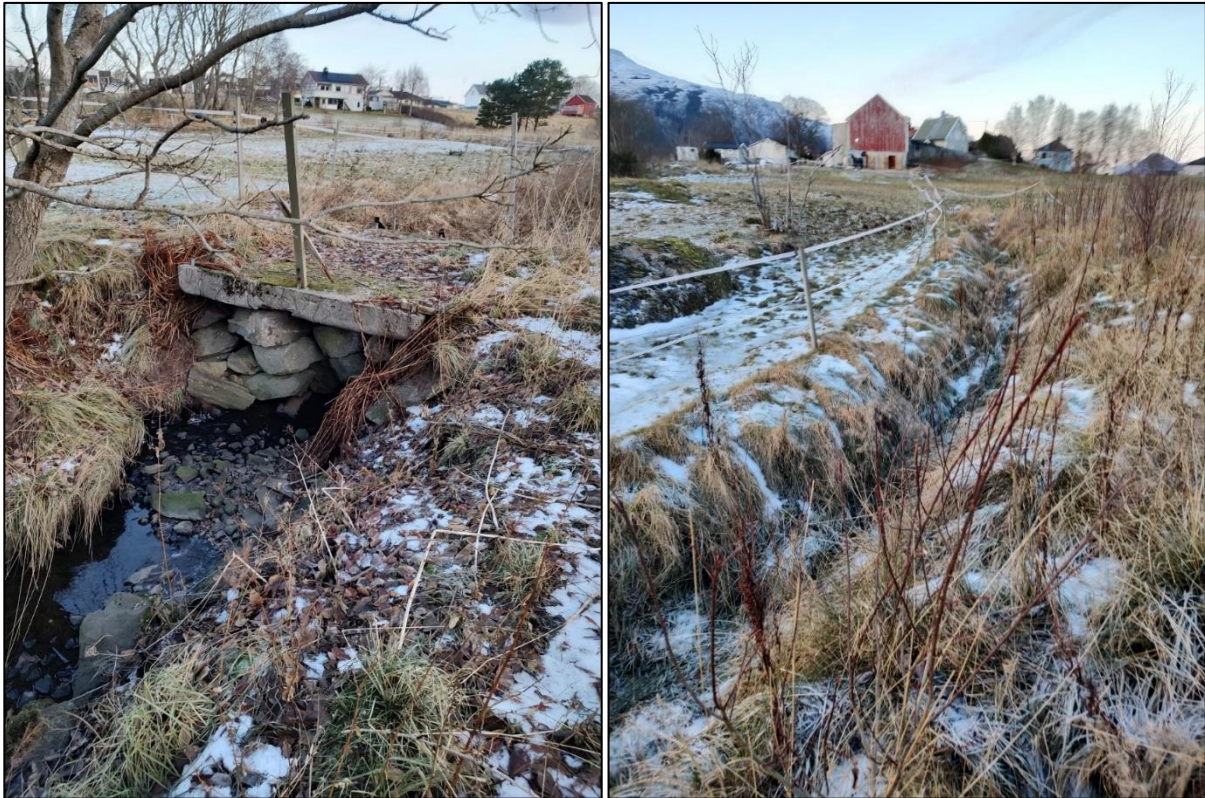
Figur 16: Venstre bilete: Gamal steinbru som er delvis kollapsa. Denne vil hindre avrenninga i området og bør fjernast. Høgre bilete: Kanal som vert kopla saman i øvre deler av planområdet.
